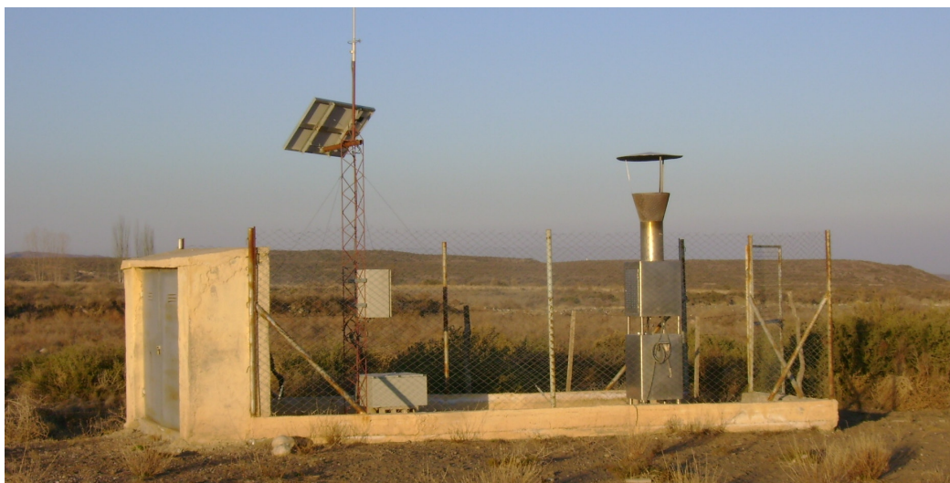
Fig. N° 5 Generador de Superficie ubicado en Estancia Lorine Bombal
